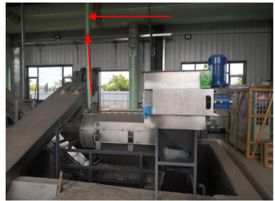
车间预处理废气收集管道
