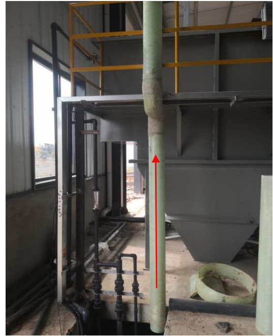
渗滤液水池废气收集管道
