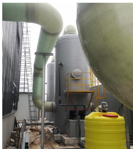
三级喷淋塔（预处理废气+污水处理废气）
