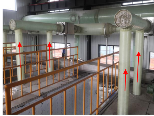
发酵仓废气收集管道
