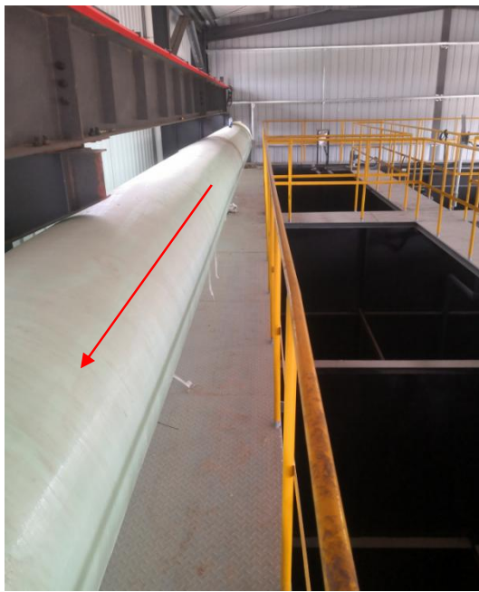
污水处理废气收集管道
