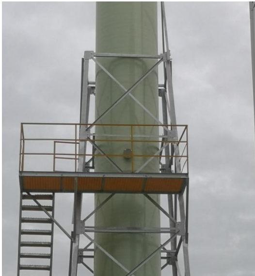
排气筒采样平台及监测孔
